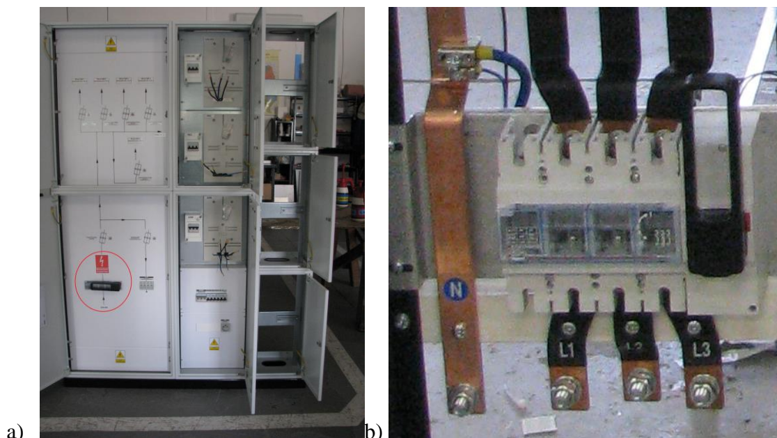
Rys.1 Przykład realizacji wyłącznika przeciwpożarowego prądu opartego na rozłączniku DPX-IS do zasilania wielolokalowego budynku mieszkalnego a) widok rozdzielnicy z osłonami, b) widok samego aparatu, [fot. Z. Ciesielski Legrand Polska], [9]
