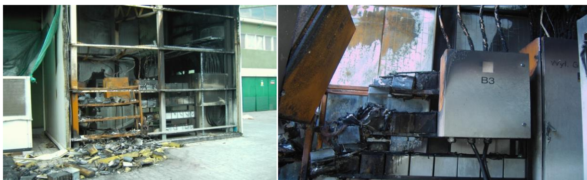
Foto. 1: Pomieszczenie bateryjne zasilacza UPS po wybuchu wodoru
